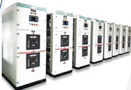
TỦ HOÀ ĐỒNG BỘ 8 MÁY GENERATOR SYNCHRONIZATION CUBICALS FOR 8 GENSETS
