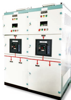
TỦ HOÀ ĐỒNG BỘ 2 MÁY GENERATOR SYNCHRONIZATION CUBICALS FOR 2 GENSETS
